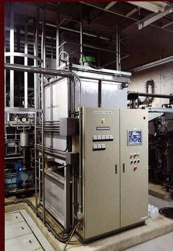
凝集沈殿装置 APC
