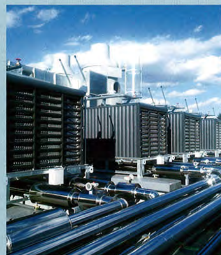
屋外冷却装置
