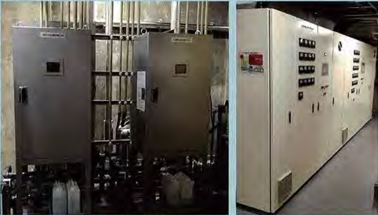
オンライン型TOC計 HK-TOC1000 制御盤
