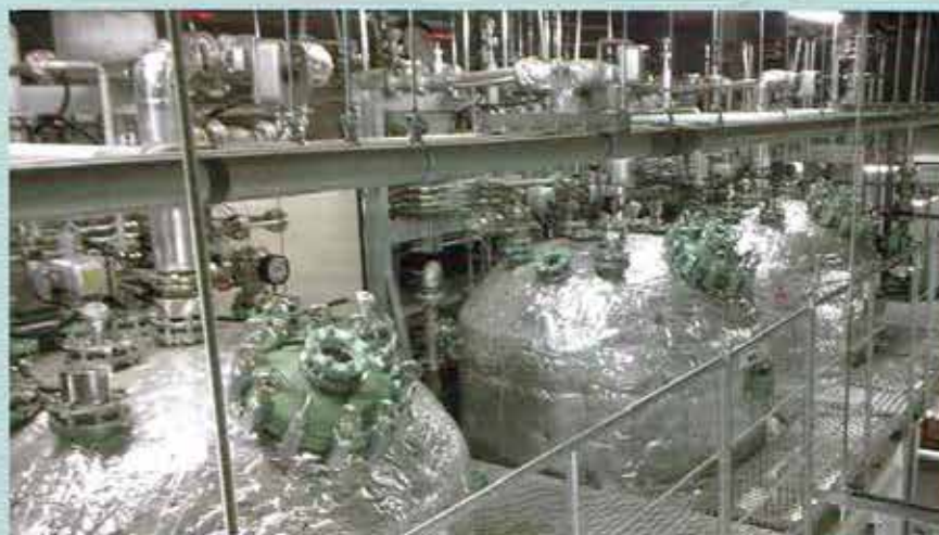
内面グラスライニング滅菌タンク
