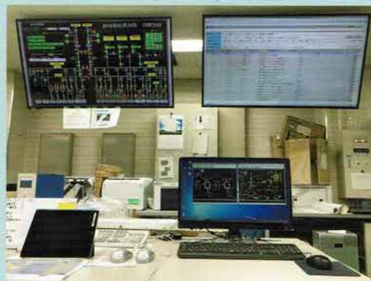
遠隔監視システム
