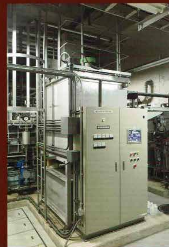
凝集沈殿装置 APC
