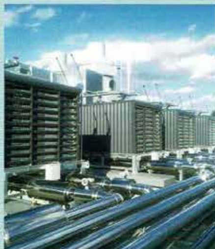
屋外冷却装置
