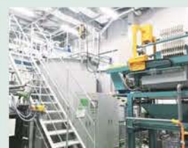
凝集処理システム APC②
