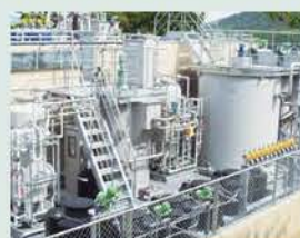
凝集処理システム APC①
