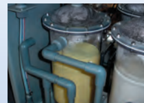
イオン交換樹脂塔
