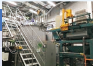
凝集処理システム APC ①
