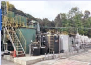
凝集処理システム APC ②
