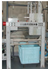
全自動汚泥脱水機
