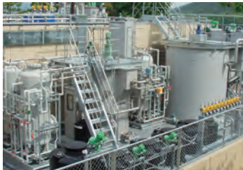
連続凝集処理設備
